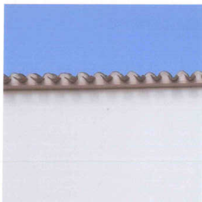
COPPI SU SPORGENZA INTONACATA 😊
