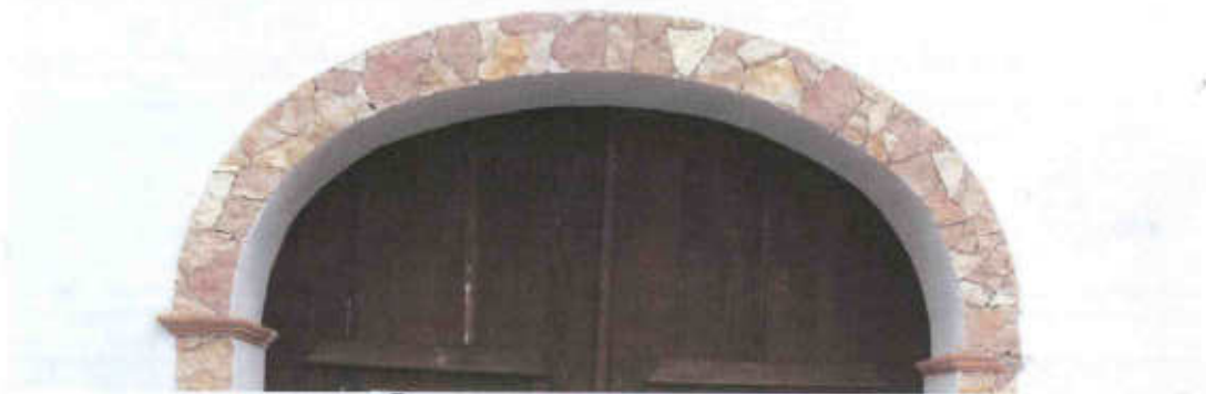
TESSITURA DEL RIVESTIMENTO 😞
