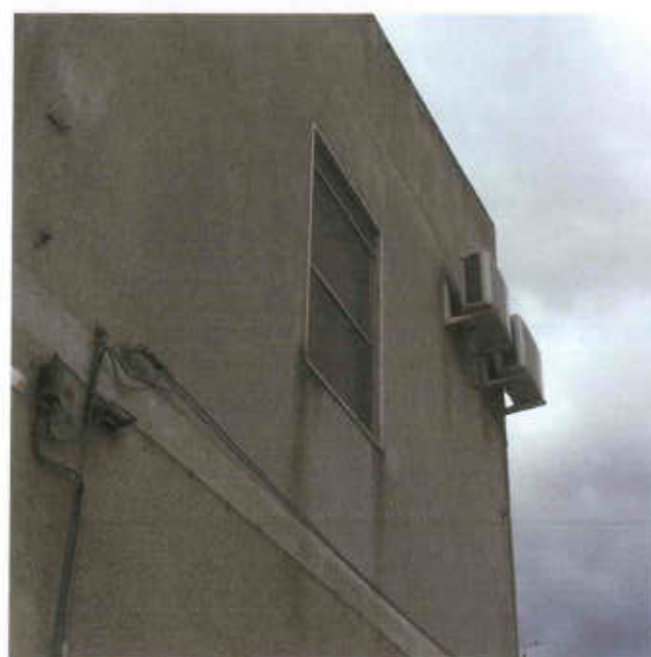
UNITA ESTERNE DI CONDIZIONATORI 🚫
