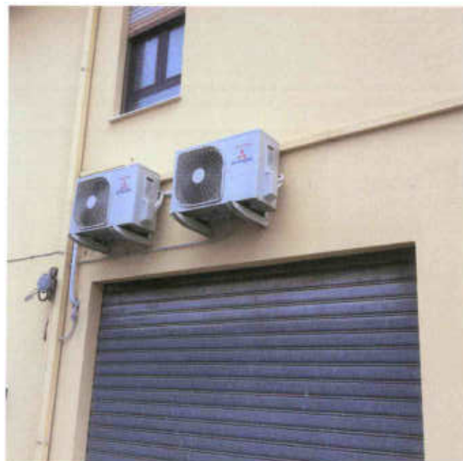
UNITA ESTERNE DI CONDIZIONATORI 🚫
